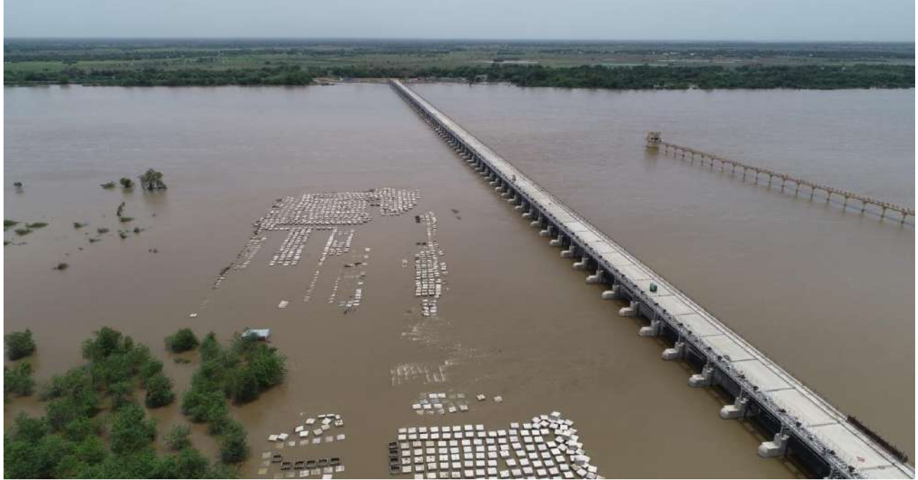
கடலூர் மற்றும் மயிலாடுதுறை மாவட்டங்கள் - கொள்ளிடம் ஆற்றின் குறுக்கே ஆதனூர் மற்றும் குமாரங்கலம் கிராமங்கள் இடையே கதவணை அமைக்கும் பணி (மதிப்பீடு ரூ. 494.60 கோடி) - மாநில நிதி
